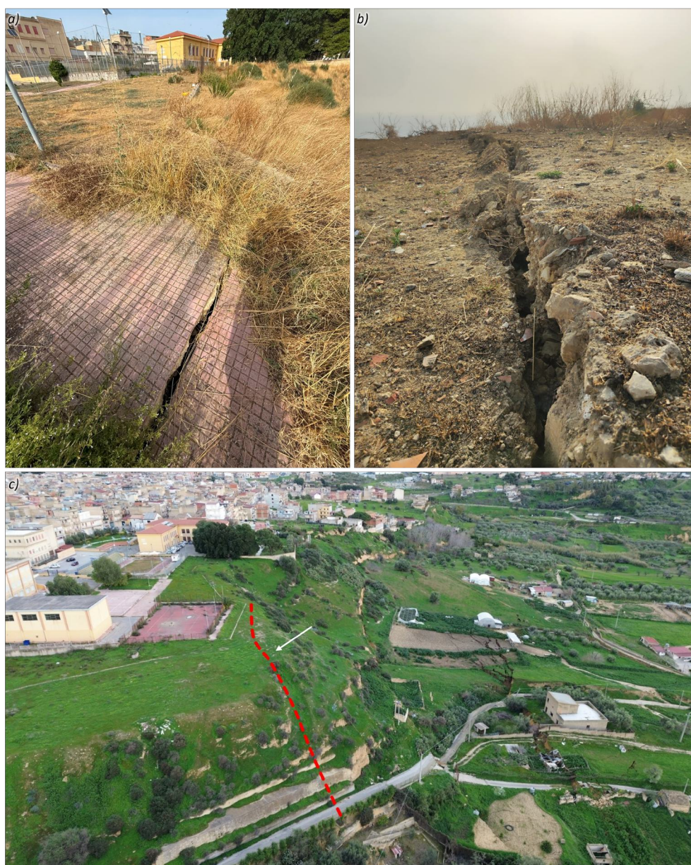
Figura 3 - Fessura rilevata a luglio 2026 nel terreno in prossimità del plesso scolastico San Giuseppe: (a) tratto in cui la discontinuità attraversa la pavimentazione del campo sportivo (foto fornita da DPC, luglio 2026); (b) dettaglio della fessura nel terreno naturale (foto CIMA, luglio 2026), la cui localizzazione è indicata con una freccia bianca nel pannello (c); (c) vista aerea del settore a gennaio 2026 (rilievo del Comune) con l'ubicazione della fessura manifestatasi nel mese di luglio (tratteggio rosso) rispetto al plesso scolastico e al campo sportivo; si osserva come essa si imponga in corrispondenza di un gradino morfologico retrostante l'attuale scarpata principale, che potrebbe pertanto rappresentare una precedente linea di scarpata.
