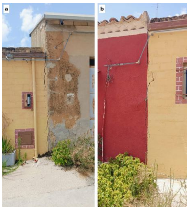
Figura 7 - Lesioni strutturali rilevate su edifici lungo via Ustica per cedimenti differenziali del terreno di fondazione. Foto fornita da DPC.
