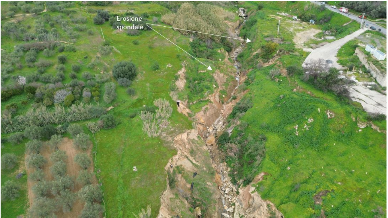
Figura 277 - Alveo e superfici spondali del torrente Benefizio in evidente stato di erosione e dissesto diffusi.
