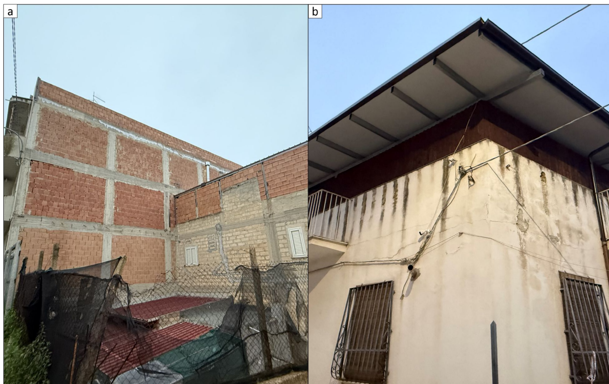
Figura 85 - Edifici nella zona del punto E. Fabbricato in cemento armato con tamponamenti in laterizio, incompleto e privo di finiture (a); fabbricato interessato da vistose fessurazioni riconducibili a problemi strutturali e alla scarsa qualità costruttiva (b).
