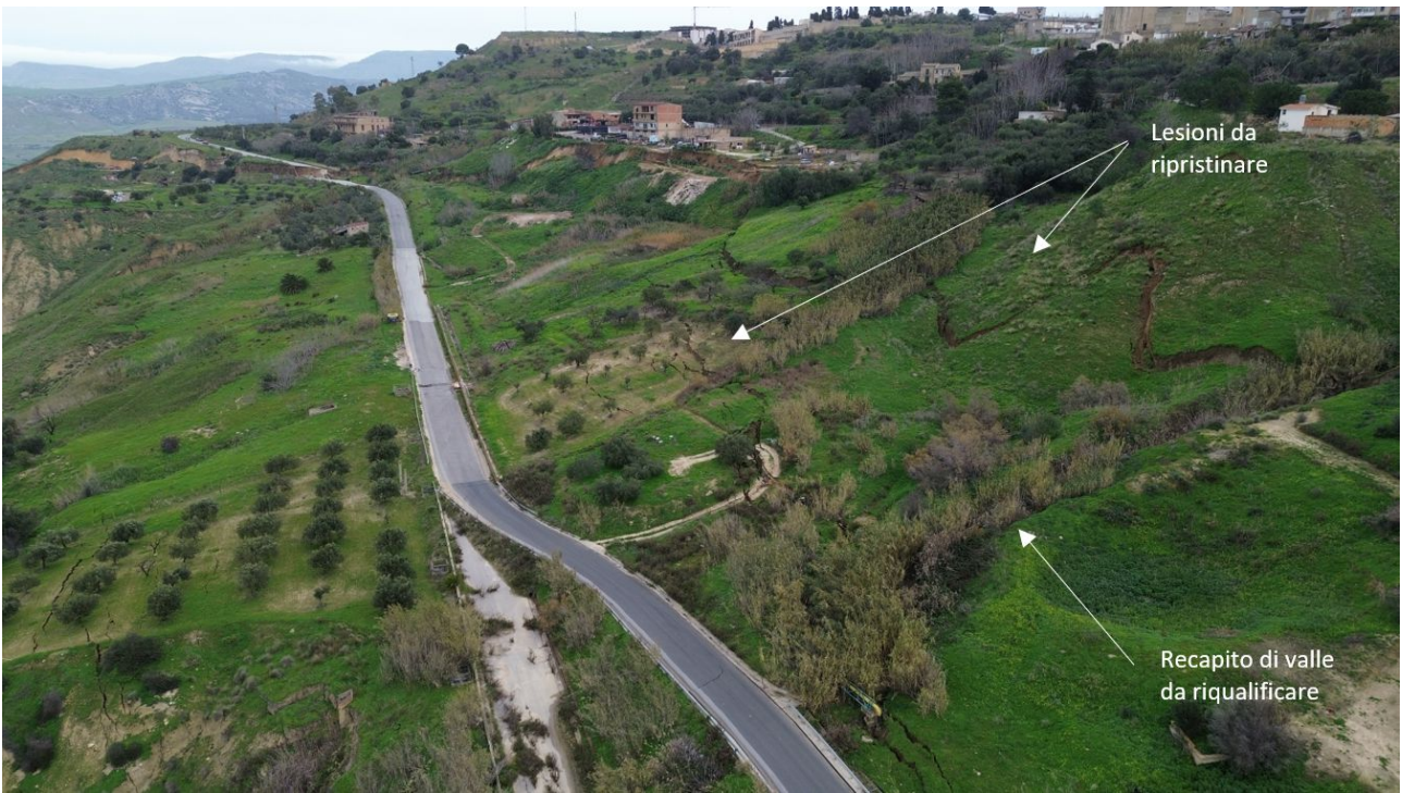
Figura 233 - Recapiti di valle da riqualificare ed evidenza sulle lesioni da ripristinare.
