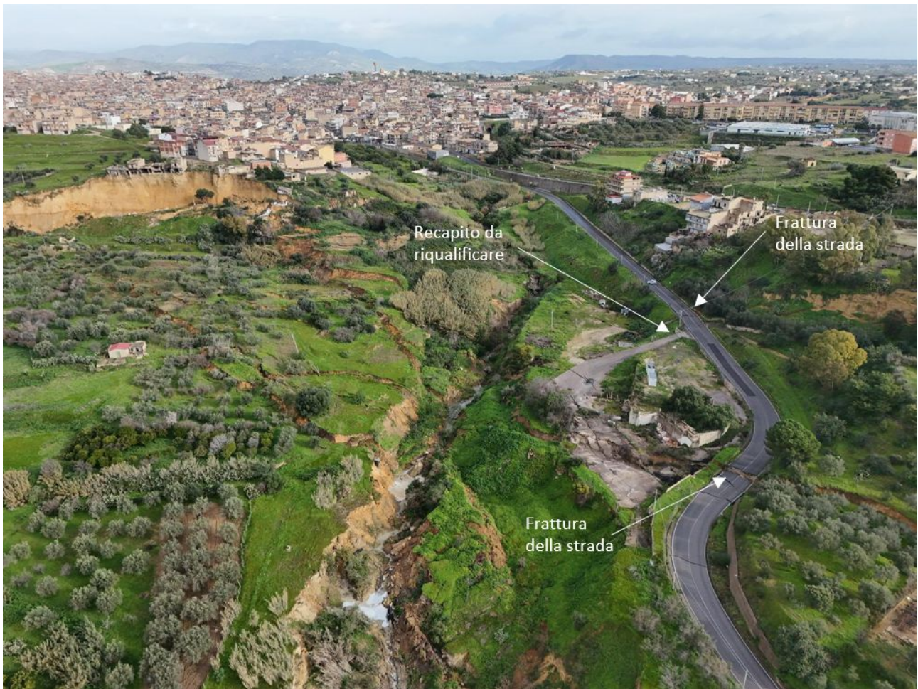
Figura 263 - Zona di interruzione della strada SP10 con necessità di ripristino stradale e di riqualificazione dei recapiti di monte, di attraversamento e di valle rispetto alla strada.
