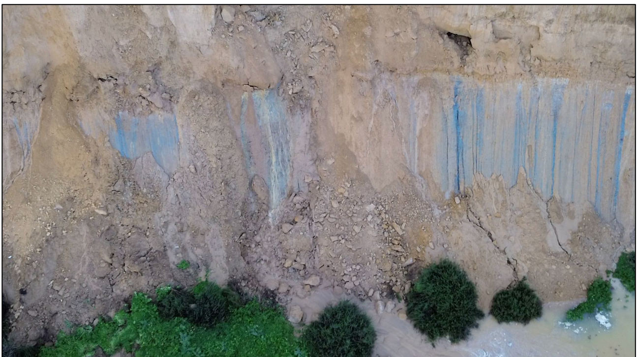
Figura 19 - Venute d'acqua lungo la scarpata della frana del 25-26 gennaio, al contatto fra le sabbie e le argille.
