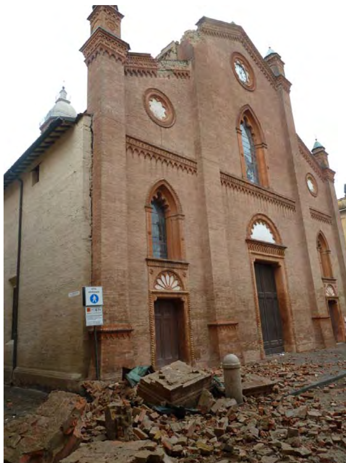
Fig. 3 – Immagine del Duomo della Mirandola (XV sec.) la mattina del 20 Maggio. Si noti la caduta di alcuni elementi architettonici del coronamento della facciata e l'incipiente distacco di quest'ultima. All'interno, non visibile, il crollo parziale delle coperture.
