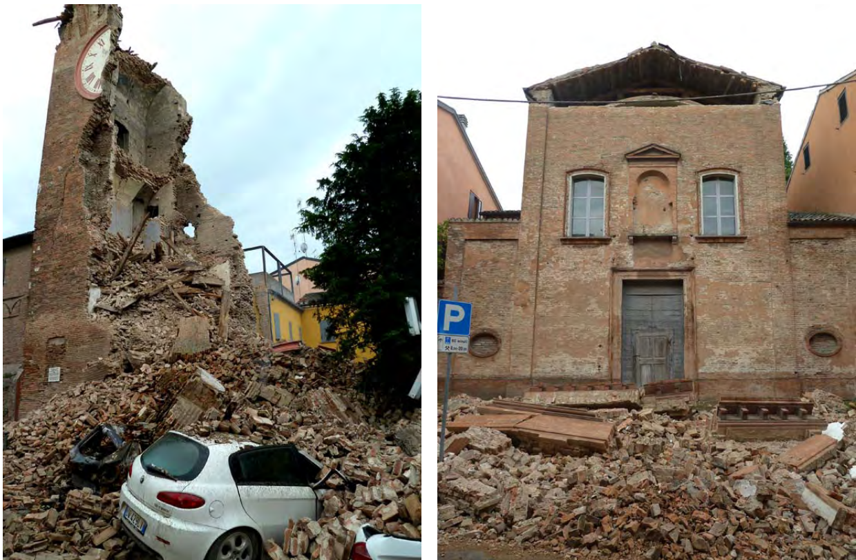
Fig. 6 – Finale Emilia, crollo della torre civica e del timpano del duomo ripresi la mattina del 20 Maggio 2012. La torre è successivamente crollata interamente nel corso della sequenza.
