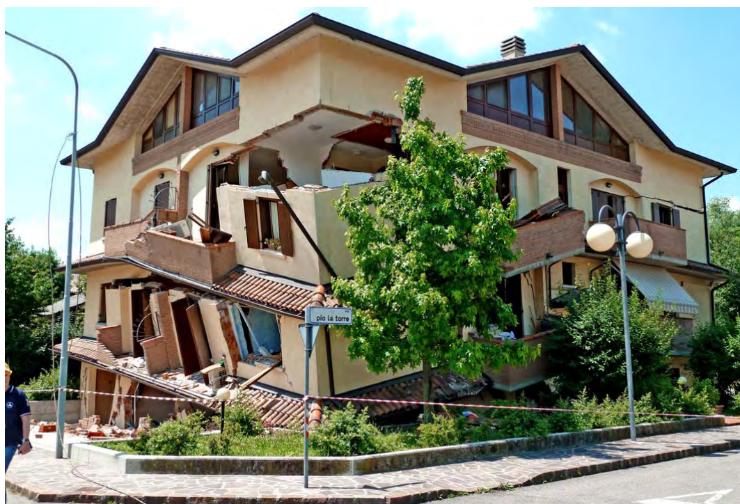
Fig. 17 – Rovereto. Caso isolato di danni gravissimi (livelli 4-5) in edilizia residenziale moderna. Collasso parziale del piano “pilotis” in muratura di un edificio nuovo all'esterno del centro storico di Rovereto. Notare la rottura a taglio dei maschi murari nel piano terra.
