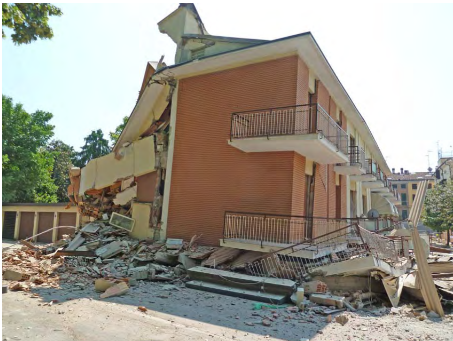
Fig. 15 – Cavezzo. Collasso totale del piano pilotis in un condominio in c.a. del centro storico ripreso la mattina del 29 Maggio.
