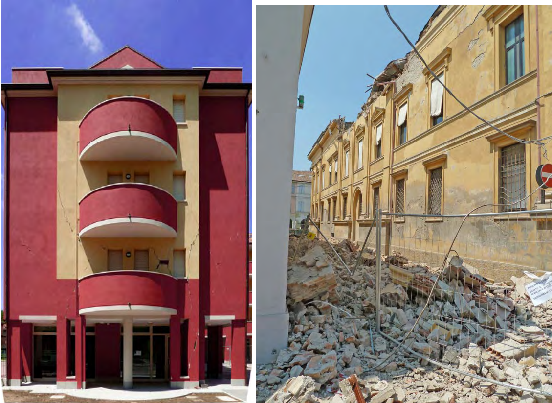
Fig. 14 – A sinistra, Rovereto, lesioni di livello 3 ad edificio in c.a. A destra, Mirandola, crollo parziale dei sottotetti di un edificio in laterizio del centro storico (foto 29 Maggio).
